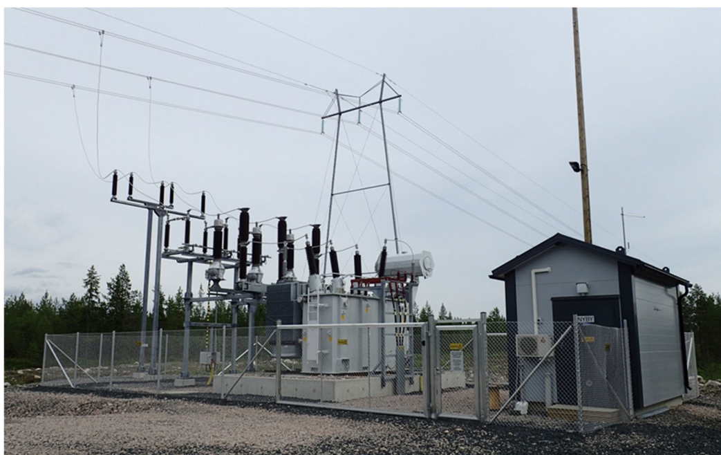
Kuva 72. Esimerkki tuulivoimapuiston sähköasemasta (kuva: FCG).
