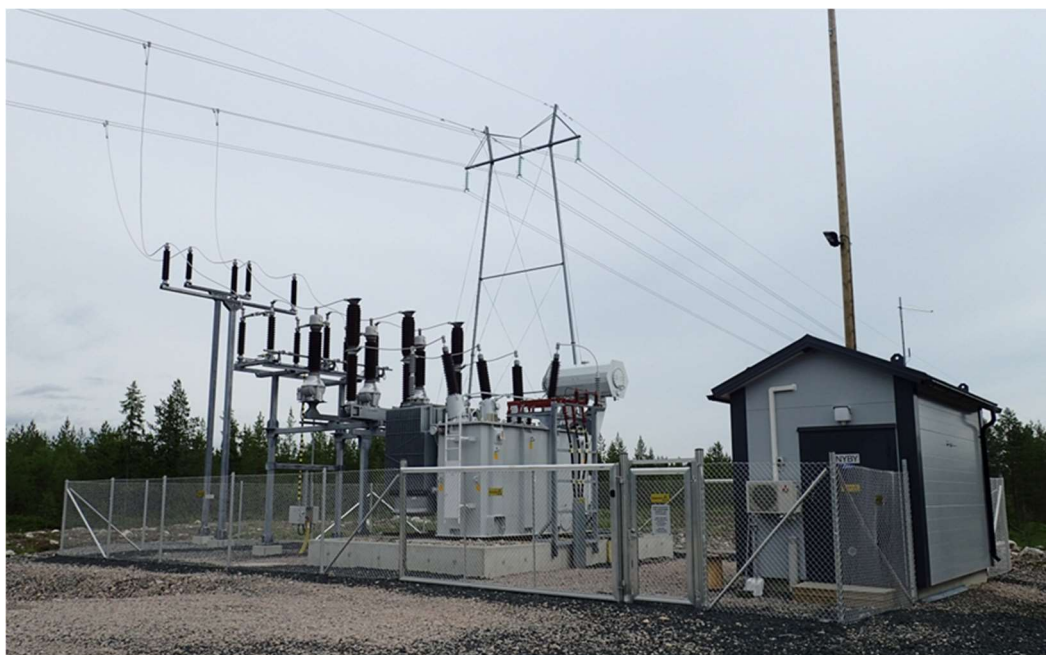
Kuva 74. Esimerkki tuulivoimapuiston sähköasemasta (kuva: FCG).
